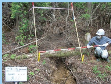
町道奥三河線 山腹亀裂の様子
